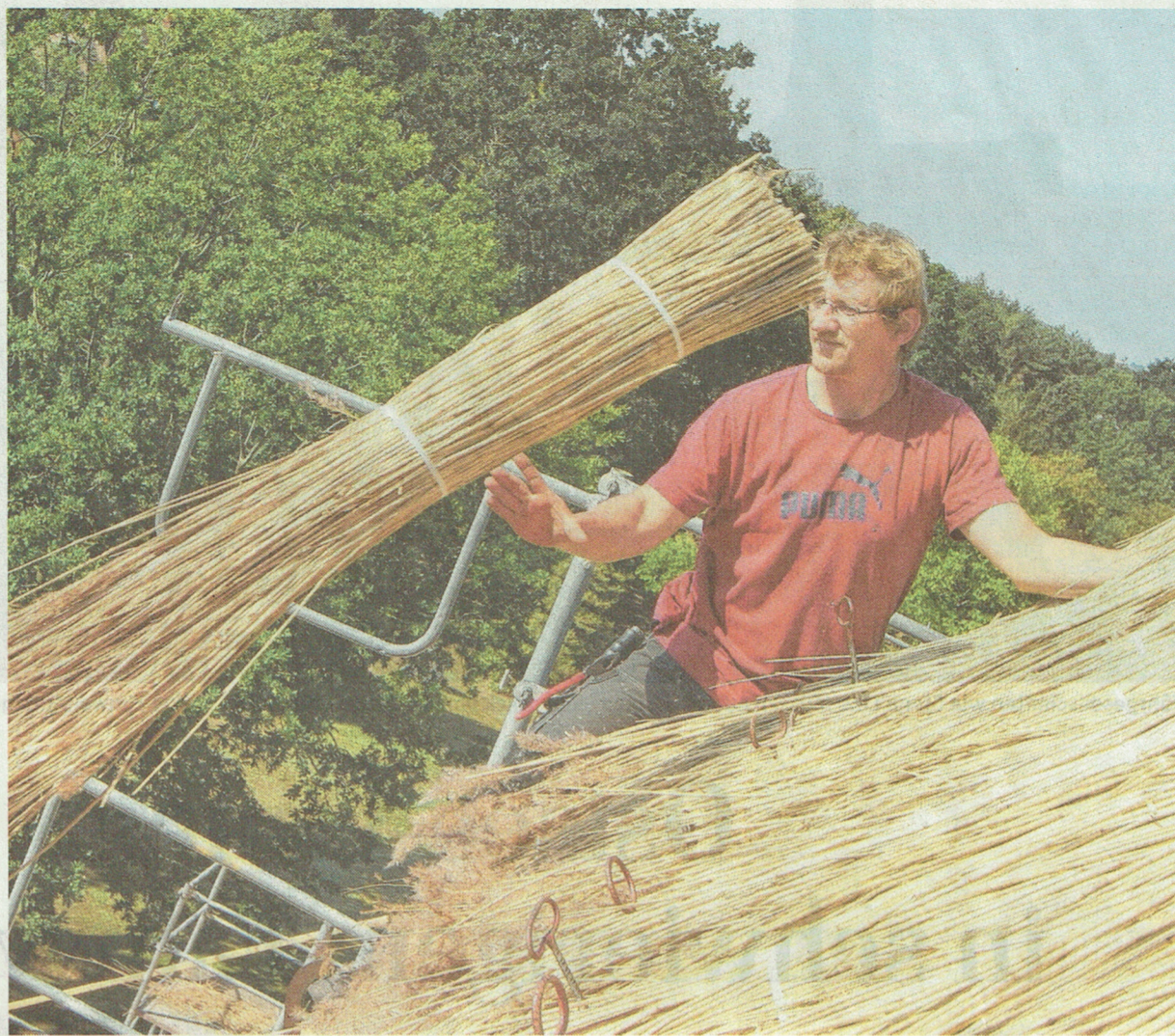
Sven Bartelt, Mitarbeiter der Rohrdachdeckerei Andreas Geldschläger aus Zingst, bei der Arbeit in Born auf dem Darß.
